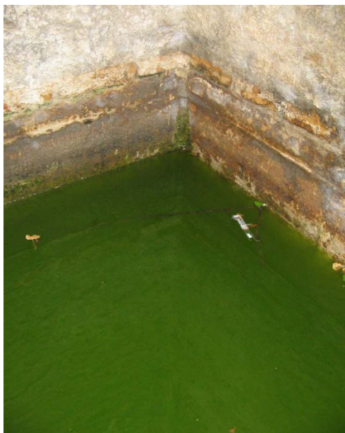
Abb. 2: 27.08.10 – rd. 4 Wochen nach der Reinigung und Neubefüllung starke Grünfärbung/Trübung.
